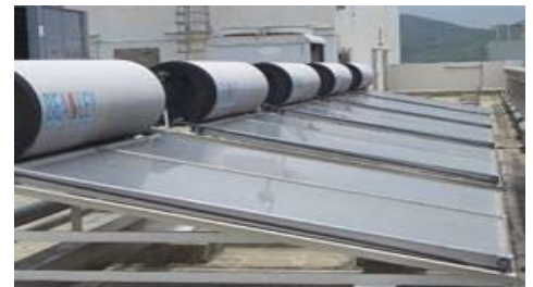
設置於港燈南丫發電廠的太陽能熱水系統
