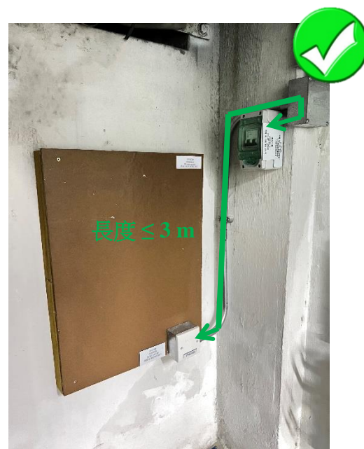
由電表通訊設施的總開關至熔斷器連接盒間的電線不應超過三米。
